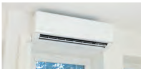
Klimatizace NORDline v nemocnici
